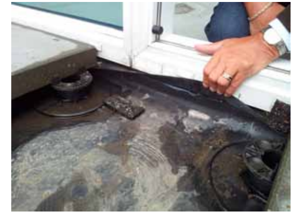
Opstandhoogte gering en slordig ingewerkt
