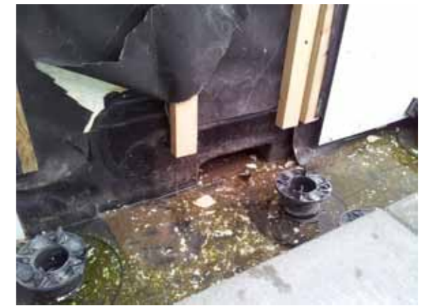
Geen drempelhoogte voor de noodafvoer en de dampopen folie ligt door de kim op het dakvlak
