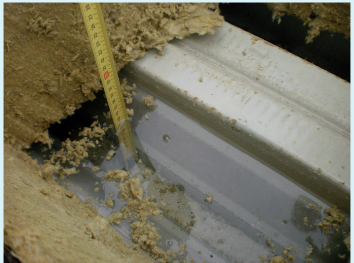
Foto 6: De cannelures stonden tot de onderzijde van de isolatie vol met water.
