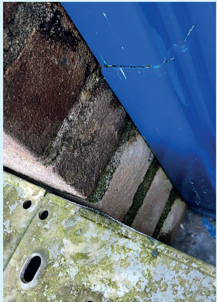
Foto 4: Met name verdacht was de aansluiting tussen de opstand en een kozijn in het opgaande werk.
