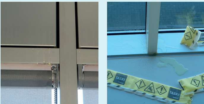
Foto 2 en 3: Gekeken wordt of er op de plaats van de lekkage verkleuring optreedt.
