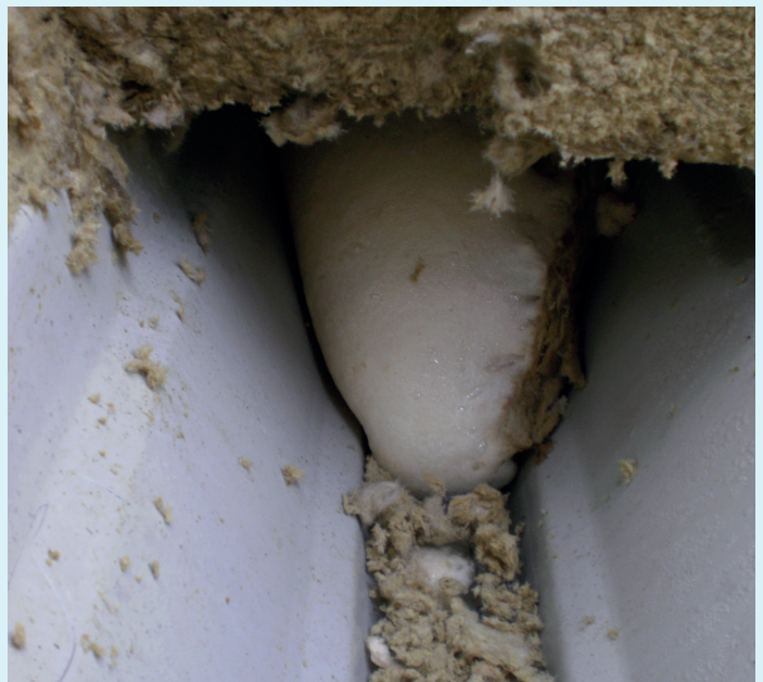
Foto 7: De koppen van de stalen dakplaten waren dichtgemaakt.
